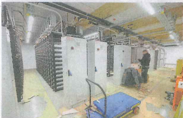
In sieben regalähnlichen „Strängen“ sind die rund 48.000 Akkuzellen der Anlage zu großen Einheiten zusammengefasst.
