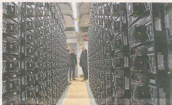
So sieht der Batteriespeicher aus.
