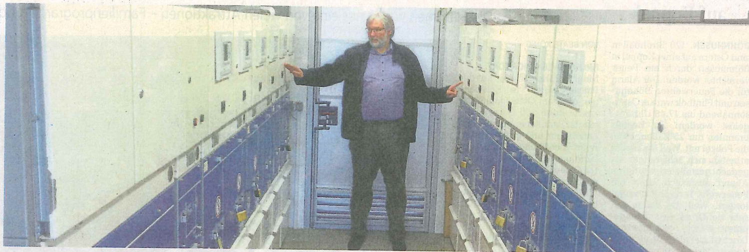
In einem kleinen Gebäude im Nienröden präsentiert VBB-Geschäftsführer Frank Günther die Stromschaltzentrale. Die Übernahme aus dem Umspannwerk gegenüber wird hier geregelt – bei einem Stromausfall würde von dort aus auch die direkte Versorgung des Batteriespeichers aus der Biogasanlage Brügge gesteuert. FOTOS: FRANK SCHEER
