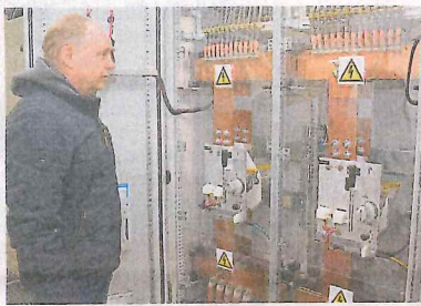
Martin Schölermann inspiziert den Schrank mit den Leitungen, die den Raum voller Akkus mit den Wechselrichtern verbinden.
