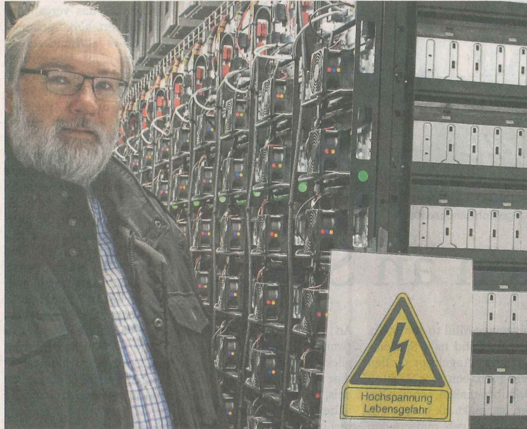
Frank Günther zeigt das Herzstück der Anlage: Das Batteriekraftwerk soll während des Testlaufs für einen störungsfreien Energieausgleich während der Ein- und Ausspeisung sorgen. FOTO: RED
